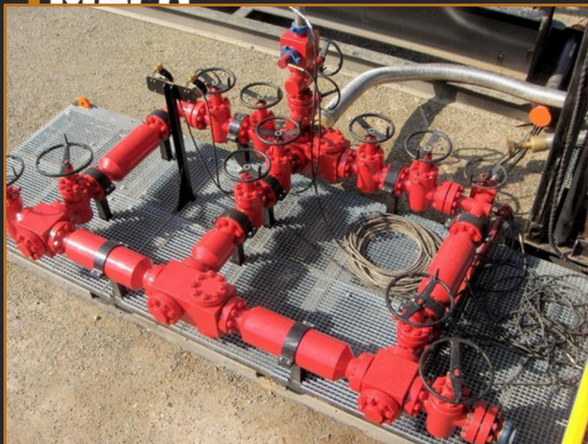
Equipement haute pression / Manifold (10000 Psi)
